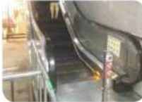
에스컬레이터 eseukeolleiteo escalator
